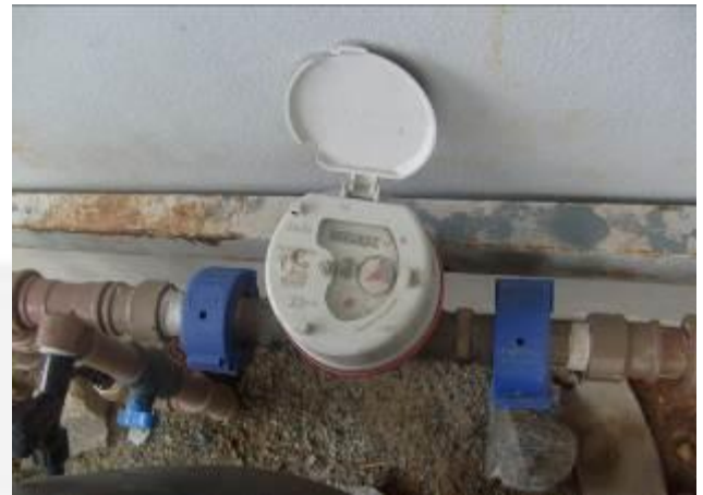
Foto 06 – Hidrômetro instalado no poço
