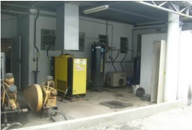
Foto 05 – Área dos compressores
