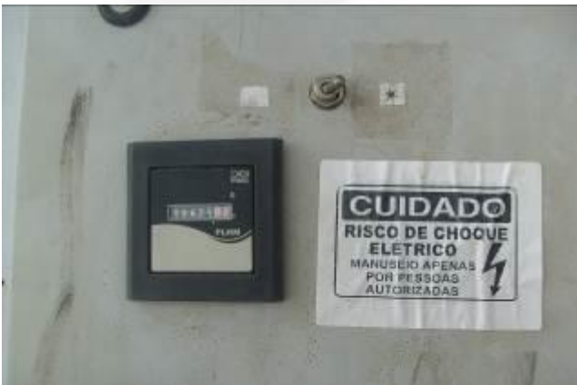
Foto 07 – Horímetro instalado no poço
