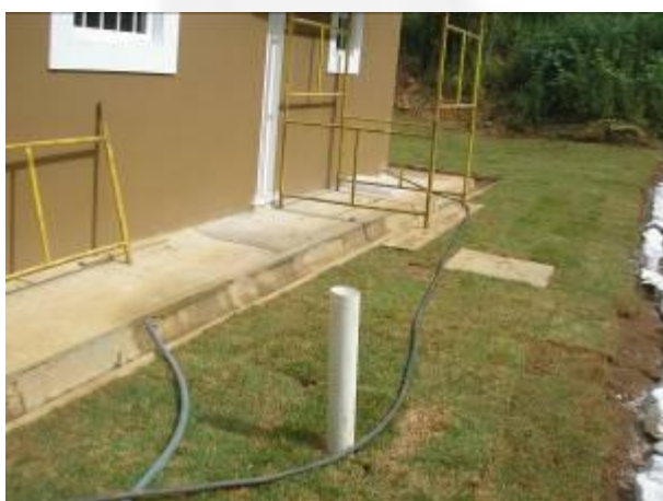
Foto 5: Local onde foi instalado o sistema de tratamento de esgoto (fossa séptica/ filtro anaeróbio).
