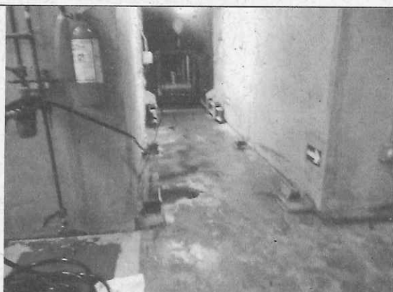
Foto 08: Interior da Unidade Geradora 01.
