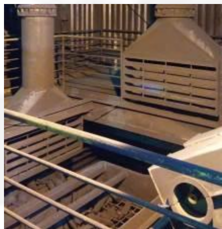
Foto 04. Área de peneiramento de carvão com sistema de despoejamento.
