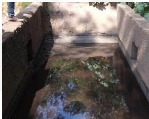
Foto 10. Caixa de decantação.
