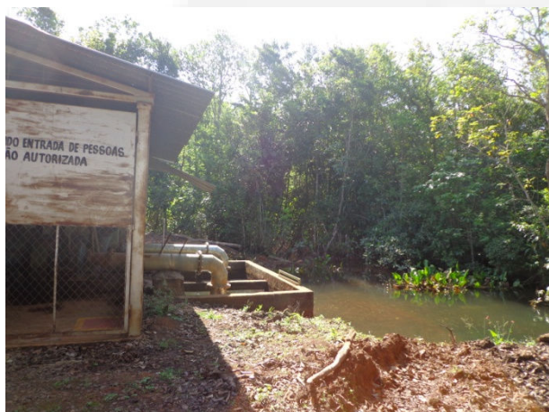
Fig. 20. Ponto de captação
