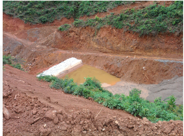
Foto 02. Dreno de fundo.
