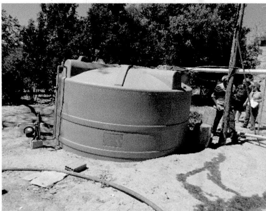
Foto 21. Caixa de captação de água
