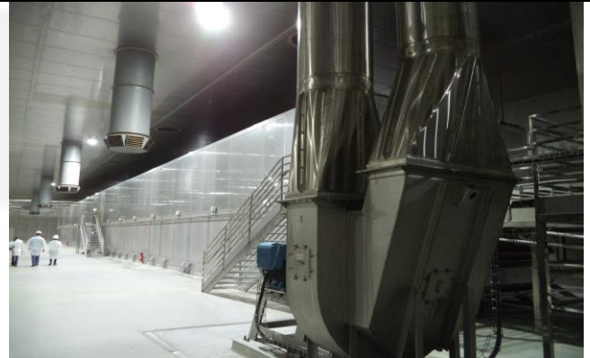
Foto 02 – Túnel de congelamento
