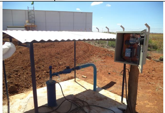
Foto 06 – Poço tubular com hidrômetro e horímetro
