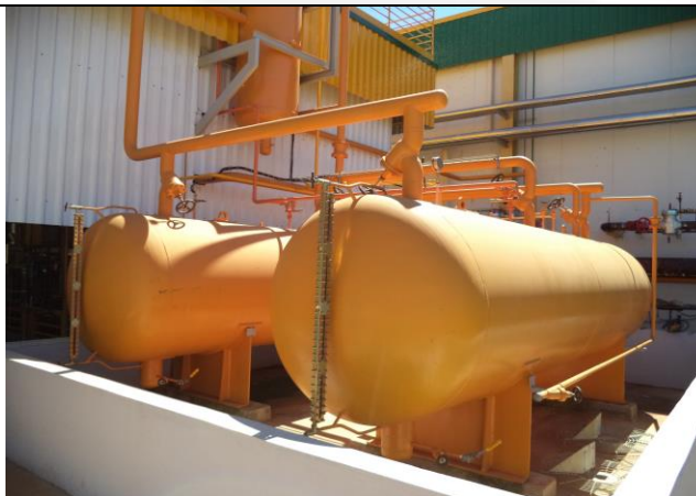
Foto 05- Tanques de amônia
