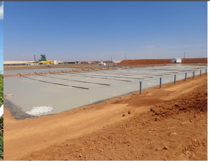
Foto 08- Área da ETE
