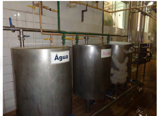
Foto 02: tanques de produtos para limpeza CIP; 28/04/2016.
