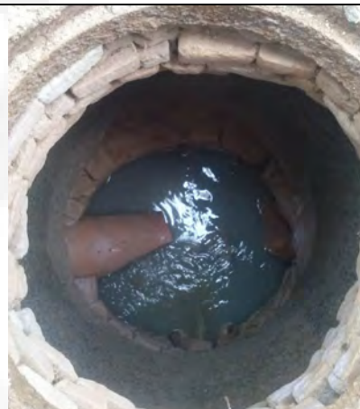
Foto 14: Lançamento do efluente industrial tratado na rede de coleta pública; junho de 2016.
