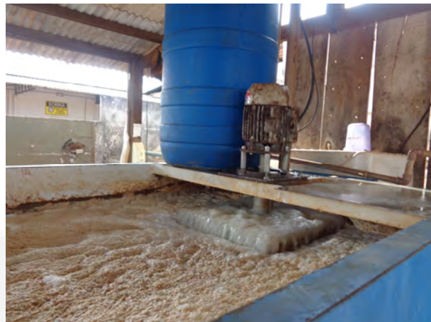
Foto 12: estação de tratamento de efluentes industriais - flotor; 28/04/2016.
