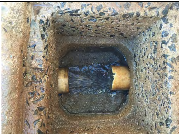
Foto 13: Caixa de passagem de efluente industrial tratado antes do lançamento na rede de coleta pública; junho de 2016.
