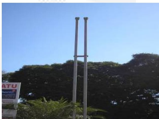
Foto 04. Respiros dos tanques.
