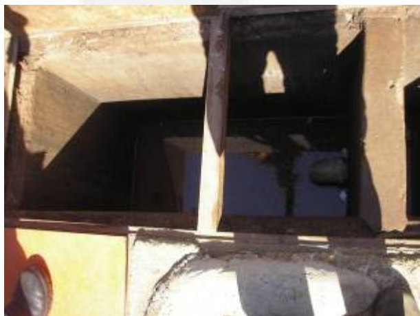
Foto 03. Caixa Separadora de Água e Óleo da pista de abastecimento.
