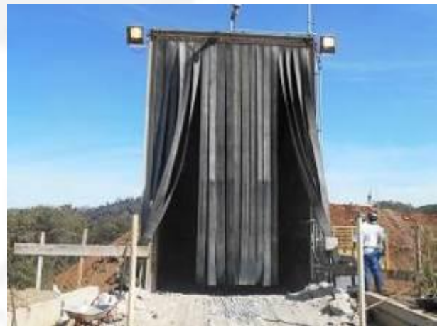
Foto 02. Moega para recebimento e transporte de matérias primas
