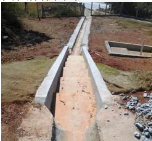
Foto 13. Sistema de drenagem pluvial.
