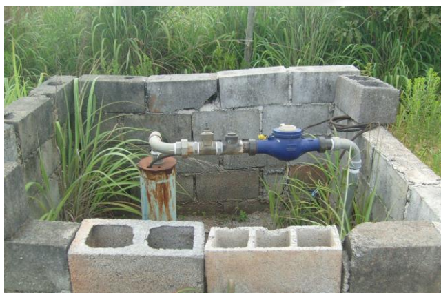
Foto 19: Poço de captação de água com medidor de vazão.
