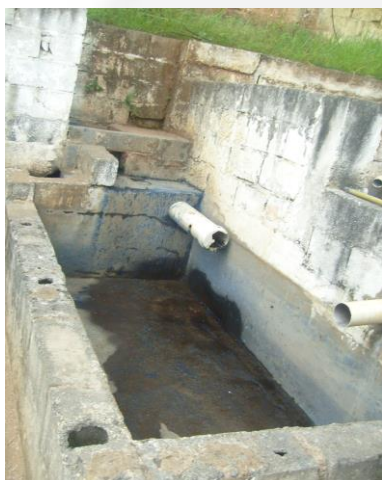
Foto 13: Tanque de homogeneização.
