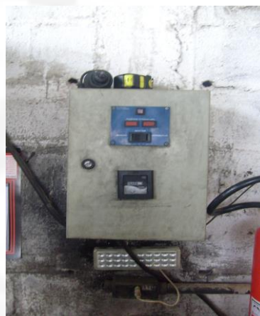
Foto 20: Horímetro do poço.
