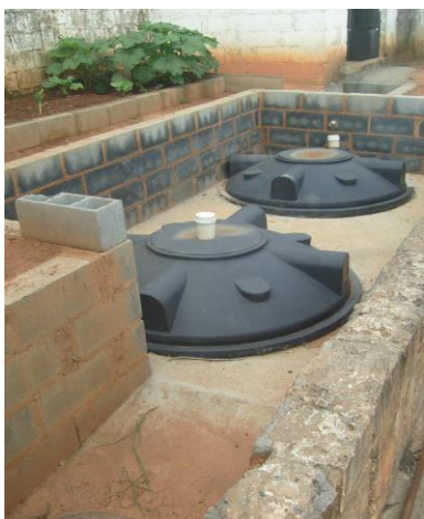
Foto 17: Estação de Tratamento de Esgoto - ETE.
