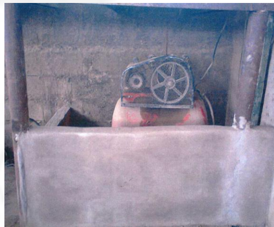
Foto 8: Compressor com bacia de contenção
