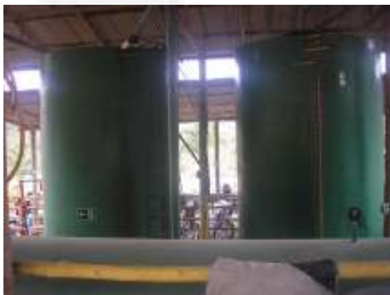
Foto 03. Reservatórios de solução de tratamento
