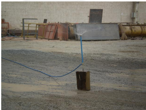
Foto 11. Sistema de aspersão de água.
