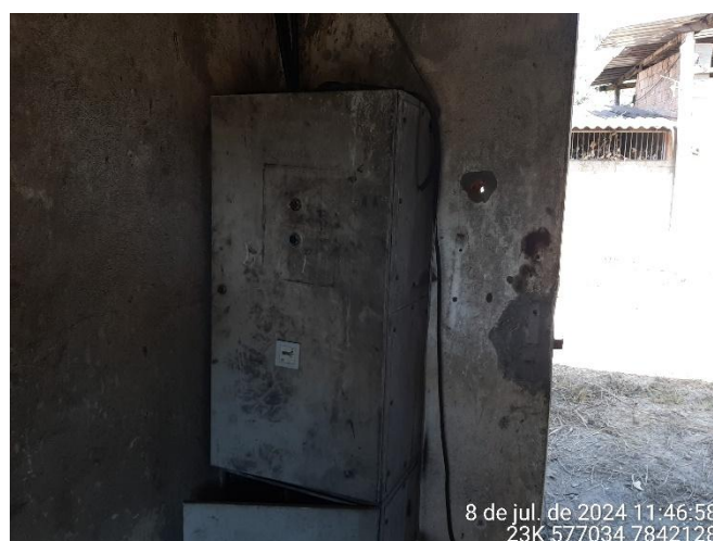
Foto 110: Horímetro da captação superficial.
