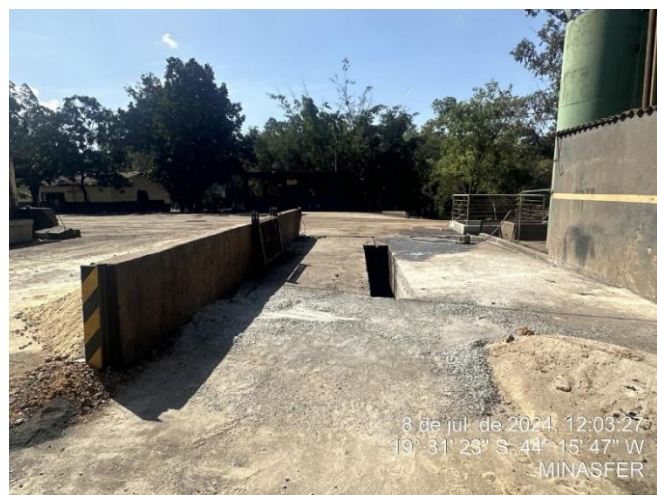
Foto 78: Área do lavador de veículos
