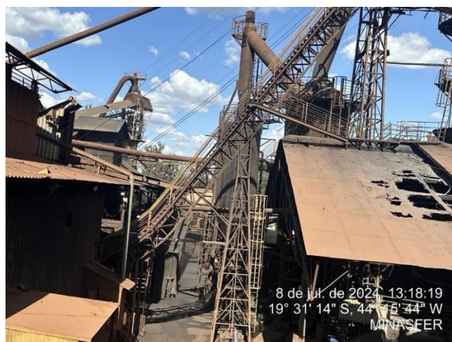
Foto 6: Detalhe do telhado do alto-forno 04 com avarias
