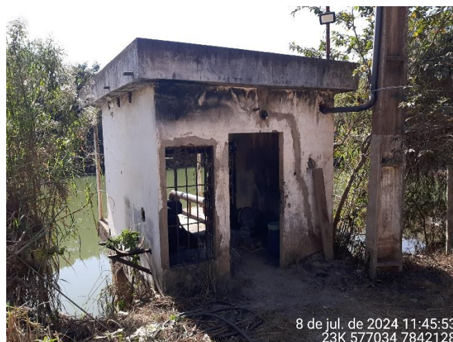
Foto 108: Casa de bombas da captação superficial.
