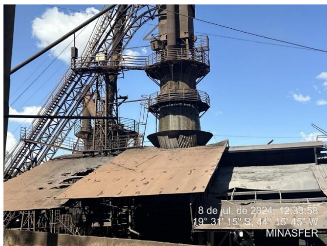
Foto 5: Telhado do alto-forno 04 com avarias
