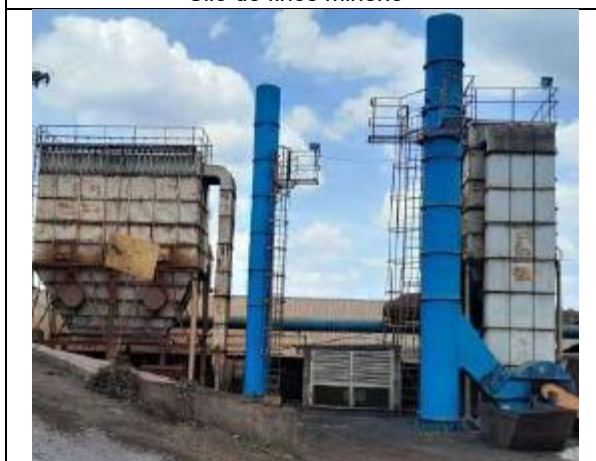
Filtros de mangas do silo de minério
