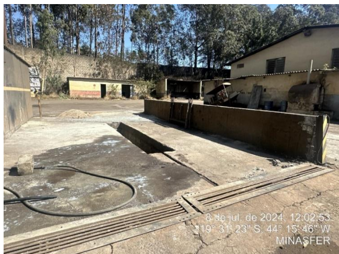
Foto 77: Área do lavador de veículos
