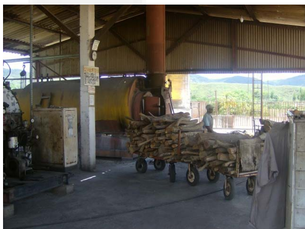
Foto 03. Caldeira a lenha do empreendimento.
