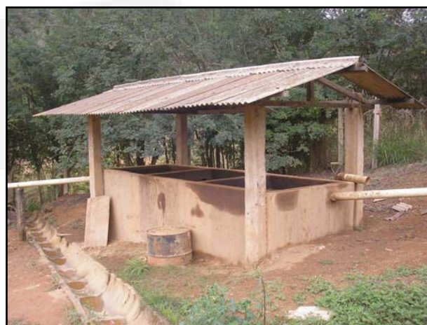
Foto 06: Caixa Separadora de Água e Óleo – Caixa SAO.
