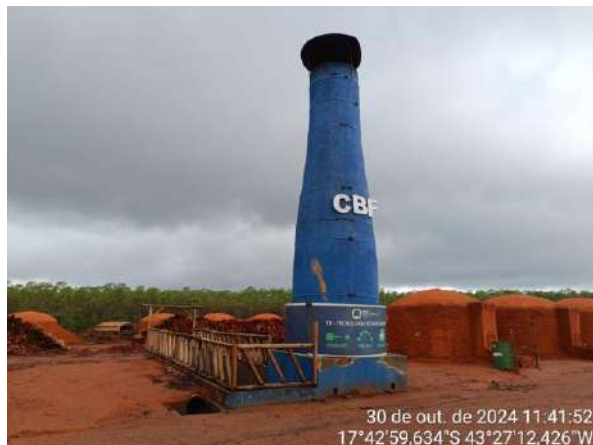
Foto 5 – Queimador de gases em teste na UB Tamboril.
