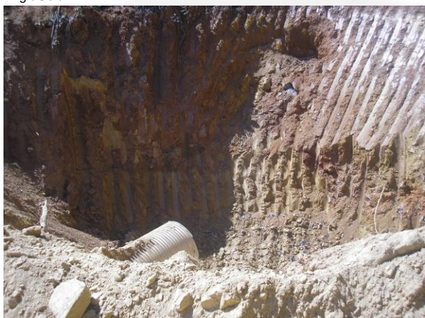
Foto 05. Sump intermediário para contenção de finos.
