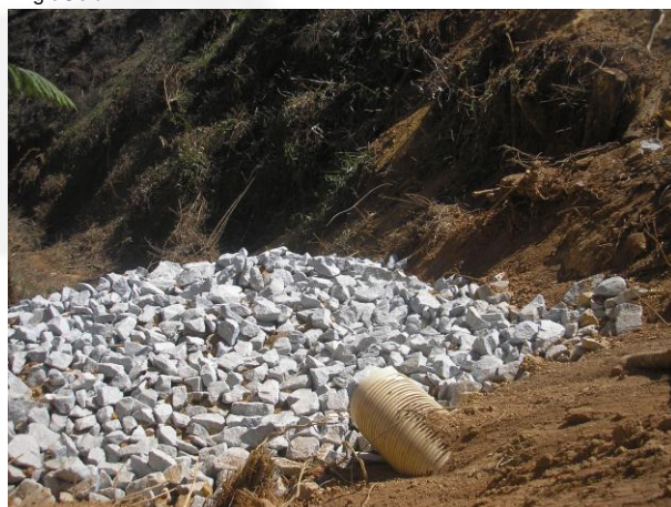
Foto 06. Sump intermediário para contenção de finos.
