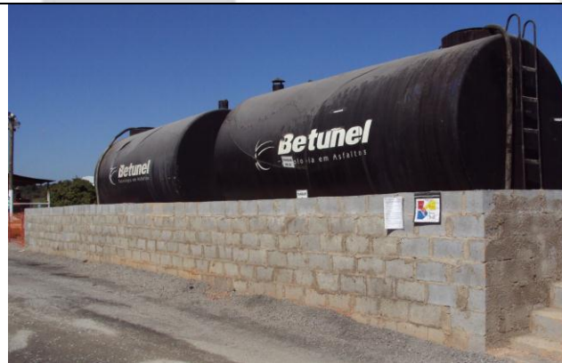
Foto 06. Tanque de RR-2C.
