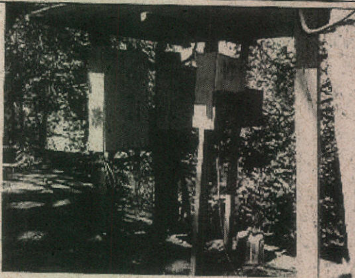
Foto 7: Painel de controle do ponto de captação.
