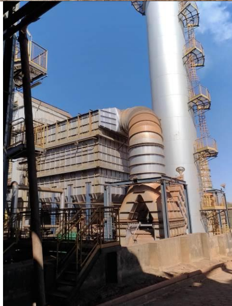
Foto 03. Lavador de gases caldeira
