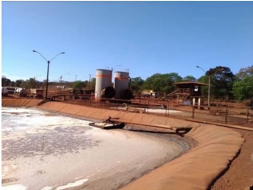
Foto 05. Tanque de vinhaça/águas residuárias
