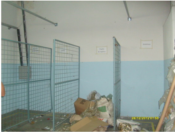
Baias de separação dos resíduos
