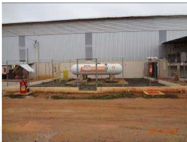
Fig. 27 – Local de armazenamento do GLP
