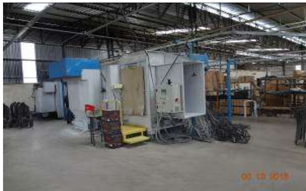
Fig. 32 - Cabines de pintura eletrostática
