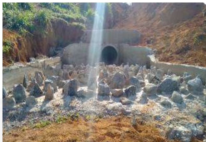
Fig. 26 - Novo local de drenagem das águas pluviais com o dissipador de energia implantado.
