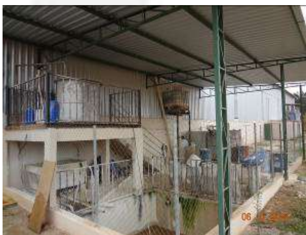
Fig. 19 - Estação de Tratamento Industrial
