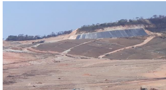
FIGURA 9 – Tanque pulmão para reservação de chorume
