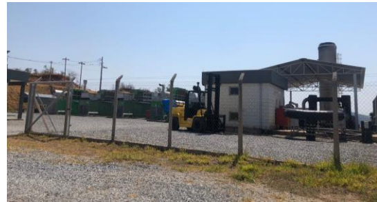
FIGURA 15 - Usina de biogás em operação
