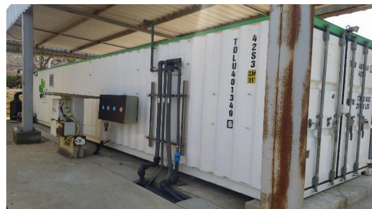
FIGURA 11 - Estação de tratamento de chorume osmose reversa
