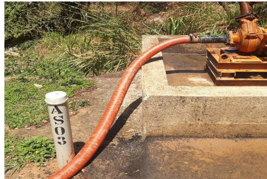
FIGURA 21 - Ponto de Monitoramento AS 03
