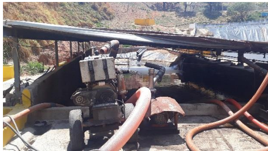
FIGURA 8 – Lagoas de Chorume e sistema de bombeamento
