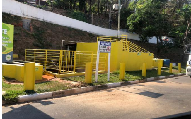
FIGURA 12 - Estação de tratamento de efluente sanitário
