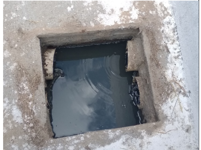
Figura 10: Compartimento final da caixa SAO (filtro instalado anexo à SÃO), efluente segue para fossa séptica, com disposição final para o curso d'água.
