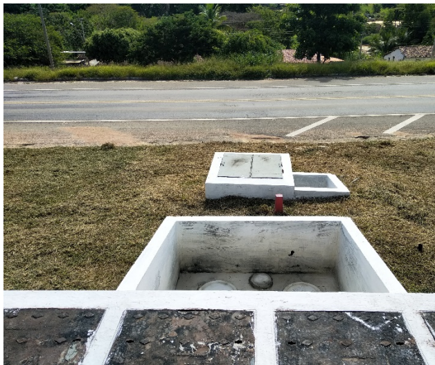
Figura 7: Caixa separadora de agua e óleo.
