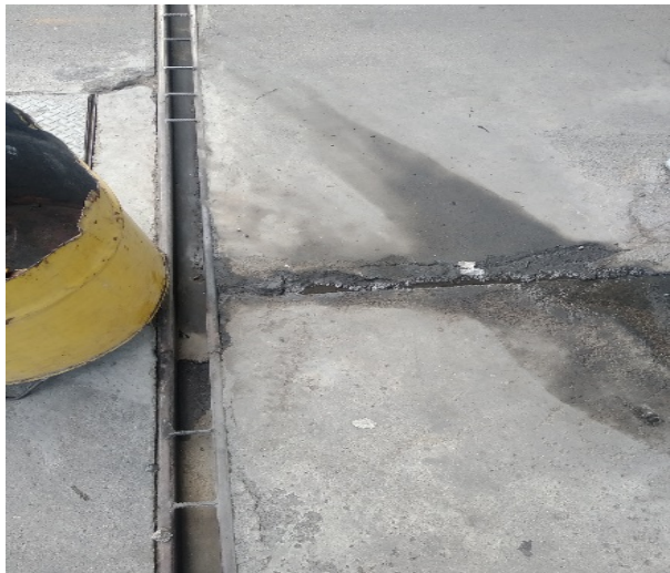
Figura 5: Trincas aparentes na pista de abastecimento.
