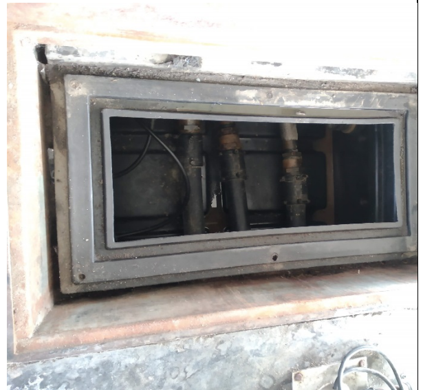
Figura 6: Sump (reservatório de contenção) do filtro de diesel.
