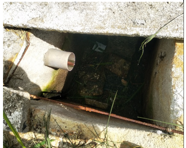
Figura 8: Caixa separadora de agua e óleo, compartimento final.
