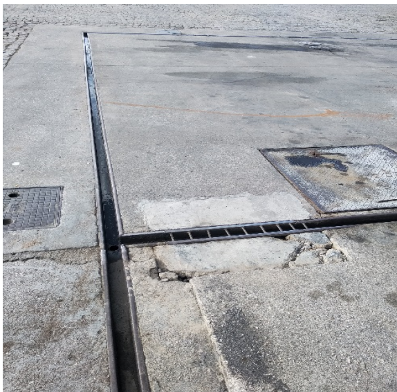
Figura 3: Trincas aparentes na pista de abastecimento.
