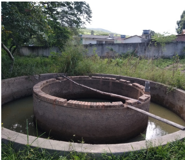
Figura 11: Compartimento desativado, utilizado para armazenar a água captada no Ribeirão São João.
