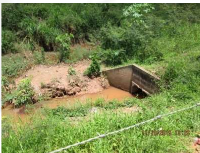
Córrego Teixeira (final canalização já existente) no local de início da intervenção
