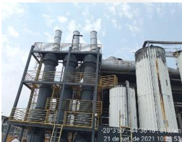
Foto 11. Lavador de gases.
