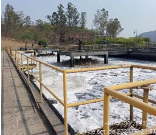
Foto 01. Estação de tratamento de efluentes industriais e sanitários.
