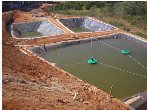
Foto 02. ETE – fase aeróbica e decantação.
