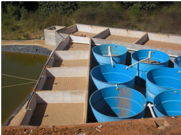
Foto 01. ETE – fase anaeróbica.
