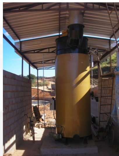
Foto 04. Detalhe da caldeira.
