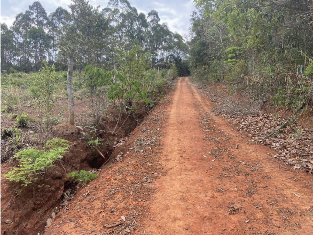
Foto 4-21 Sulco na margem da via de acesso
