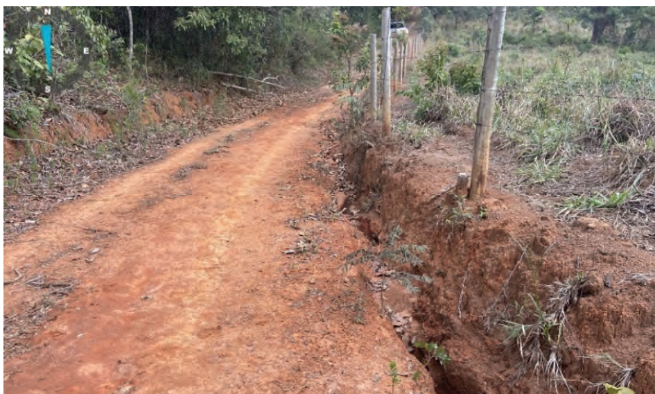
Foto 4-25 Ravina profunda na lateral acesso no interior da RPPN
