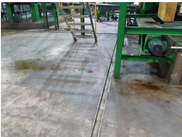
Figura 03. Canaletas de drenagem na área de produção
