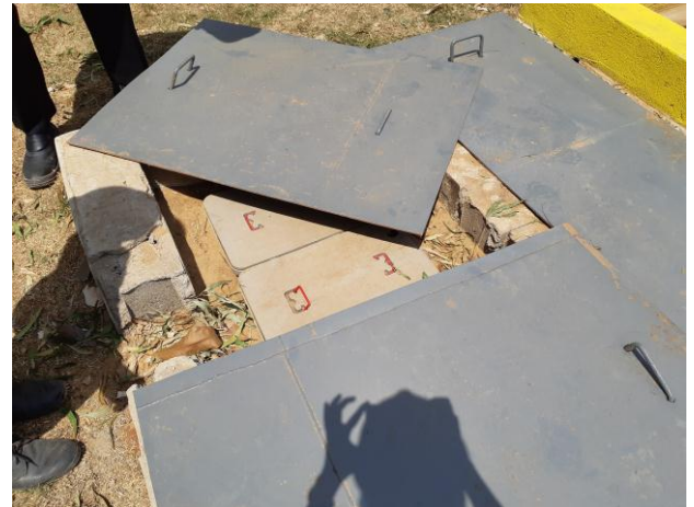
Figura 02. Caixa separadora de água e óleo
