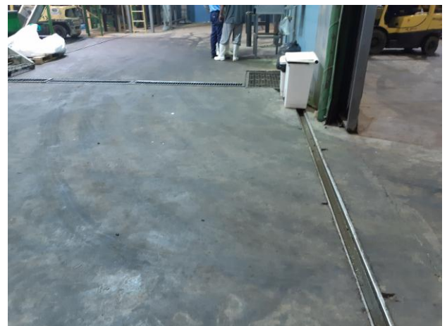
Figura 04. Canaletas de drenagem na área de produção
