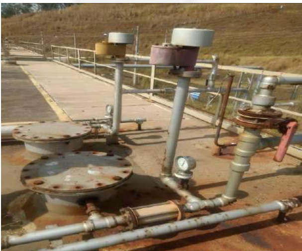
Corrosão na tubulação de coleta do Biogás
