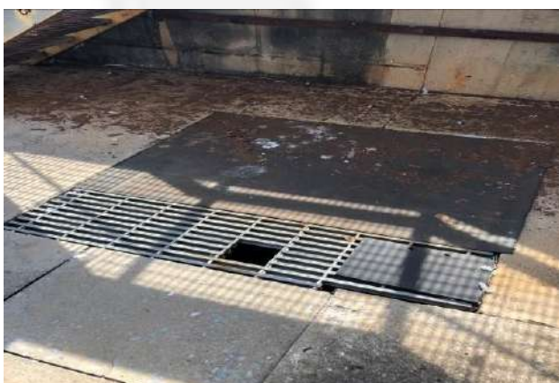
Grades Pultrudadas dos reatores anaeróbicos
