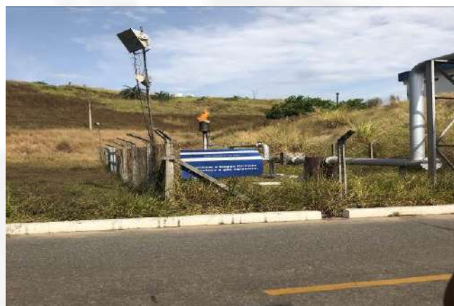
Queimador de Biogás
