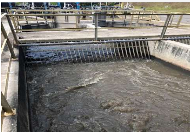
Gradeamento ( Tratamento Preliminar)
