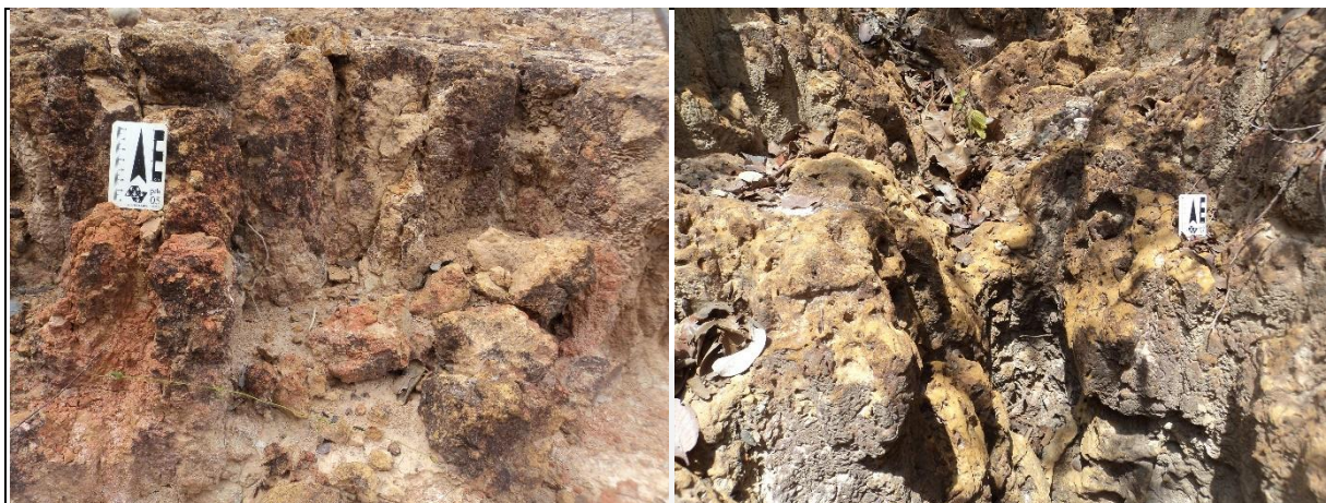
Figura 12: Crosta laterítica friável e laterita exposta junto à calha de drenagem
