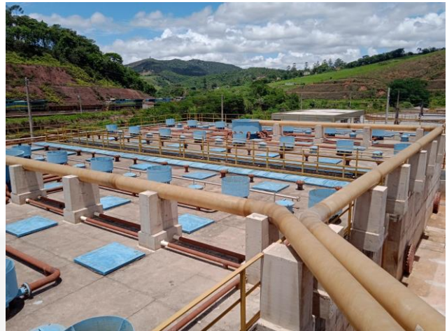
Foto 06: reatores anaeróbios de fluxo ascendente e manta de lodo (UASB).
