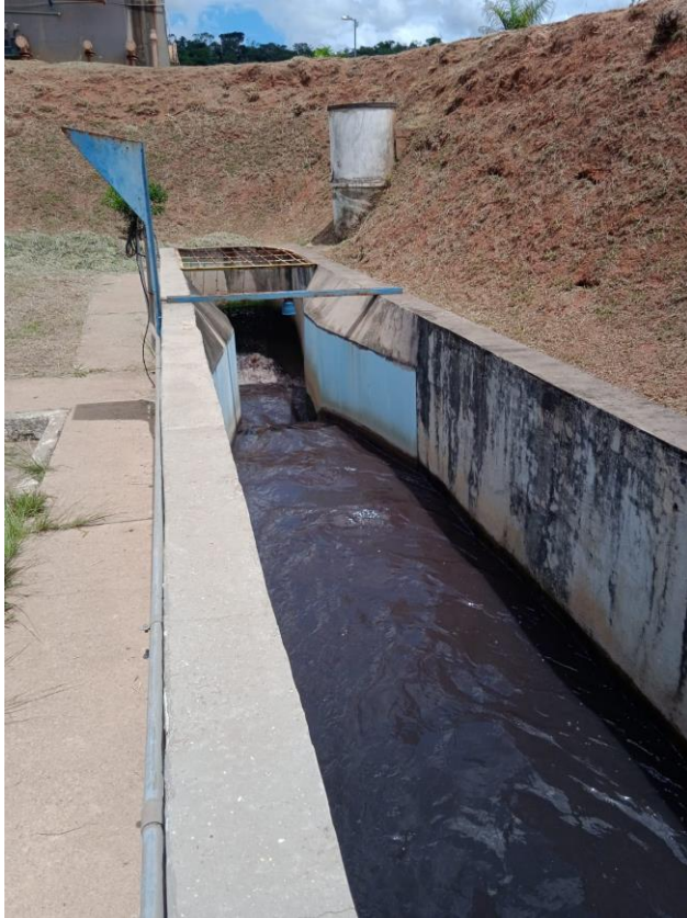
Foto 01: Medidor de vazão, calha Parshall.
