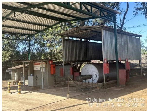
Foto 74: Vista do posto de abastecimento
