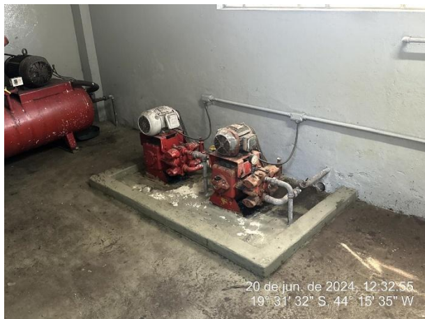
Foto 73: Área de compressores
