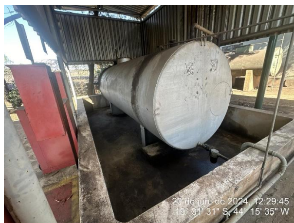
Foto 76: Tanque de combustível
