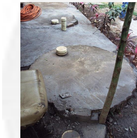
Foto 07. Tratamento de efl. Sanitários.
