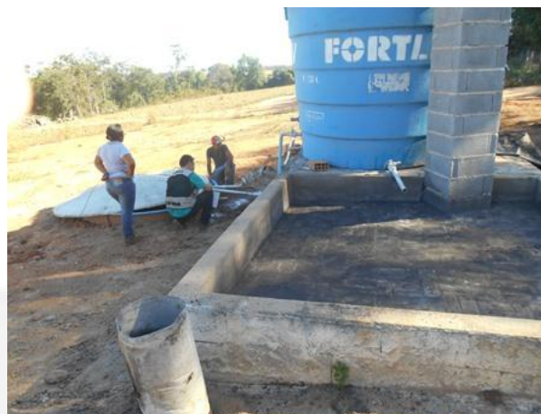
Foto 06. Tratamento de efluentes industriais
