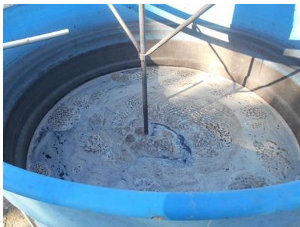
Foto 05. Tratamento de efluentes industriais
