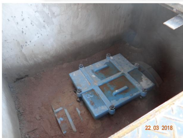
Figura 19. Caixa separadora de água e óleo - CSAO (fonte: relatório técnico fotográfico - Gecon – consultoria ambiental, 2018)
