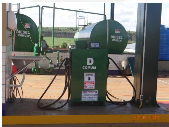
Figura 17. Bomba de abastecimento e tanques ao fundo com bacia de contenção (fonte: relatório técnico fotográfico - Gecon – consultoria ambiental, 2018)
