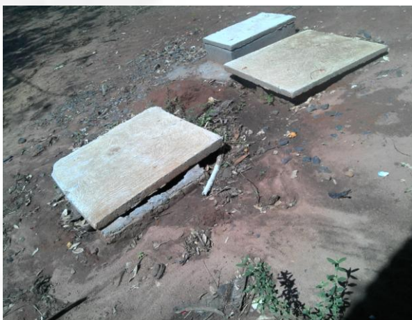
Figura 12. Fossa biodigestora e sumidouro
