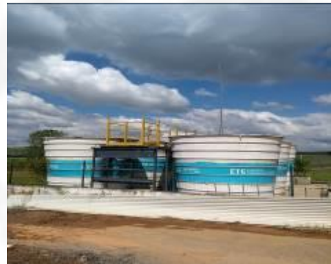
Foto 04. ETE Sanitária – Industrial Sul
