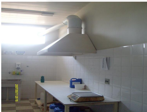
Foto 03. Sistema de Exaustor
