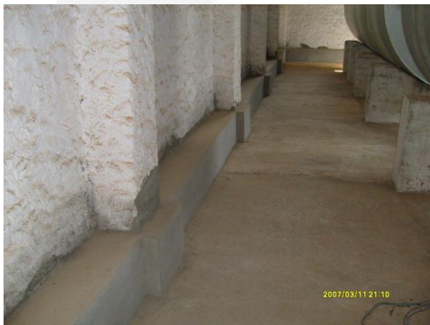
Foto 07. Bacia de Contenção
