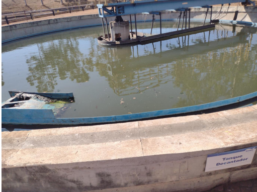
Tanque decantador da ETE
