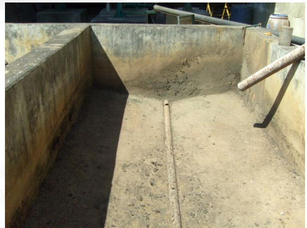
Foto 10. Leito de secagem do lodo
