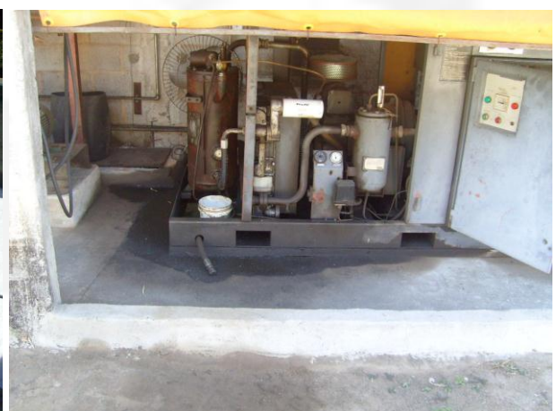
Foto 12. Compressores com bacia de contenção
