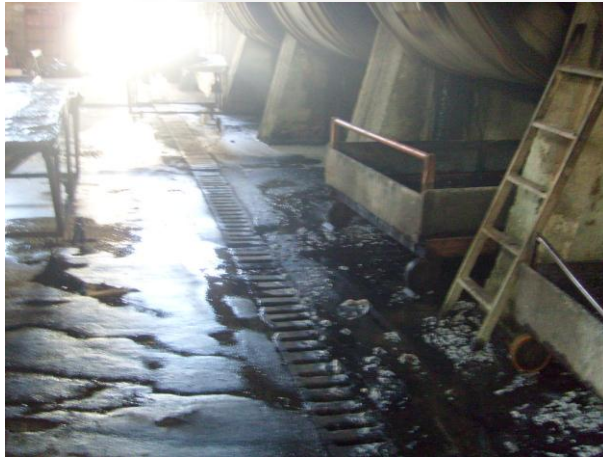
Foto 01. Sistema de drenagem do efluente líquido industrial
