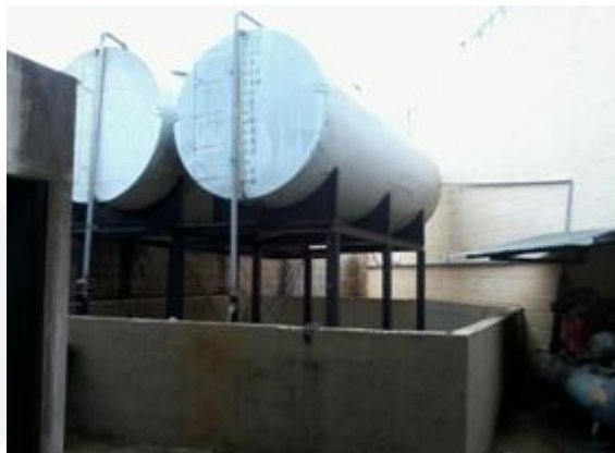
Foto 6: Tanques de armazenamento de óleo.
