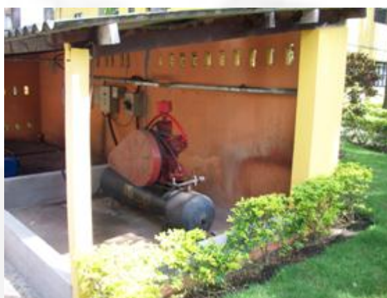
Foto 16: Compressor com bacia de contenção.
