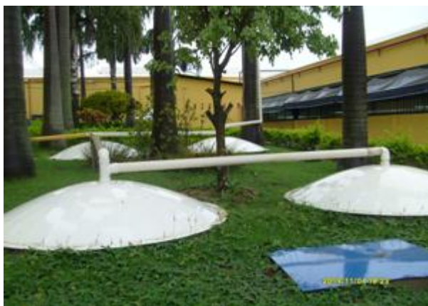
Foto 17: Sistema de tratamento de efluentes líquidos sanitários
