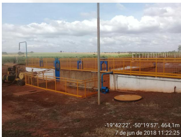
Figura 8- Tratamento dos efluentes líquidos oleosos.
