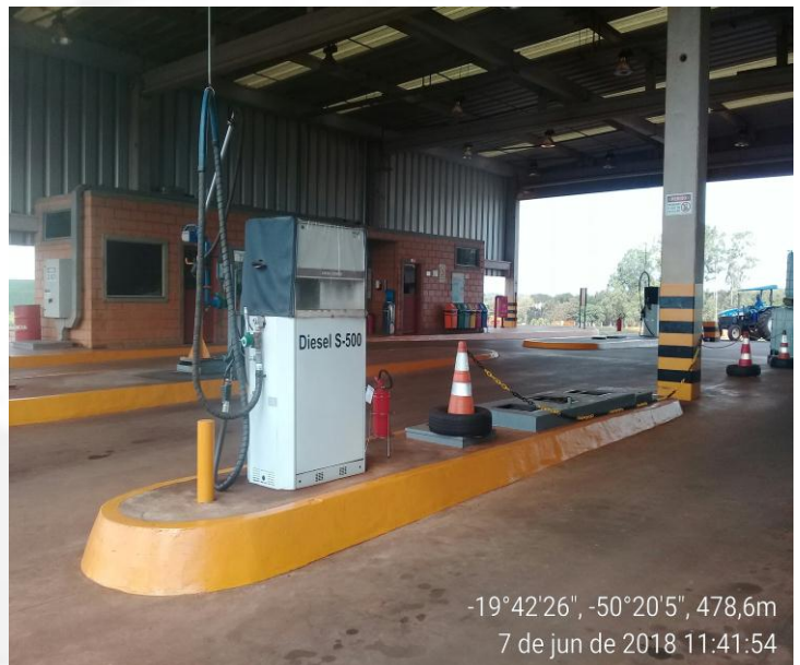
Figura 5- O posto trabalha com 05 bombas de abastecimento sendo uma bomba de alta vazão para abastecimento de óleo diesel.
