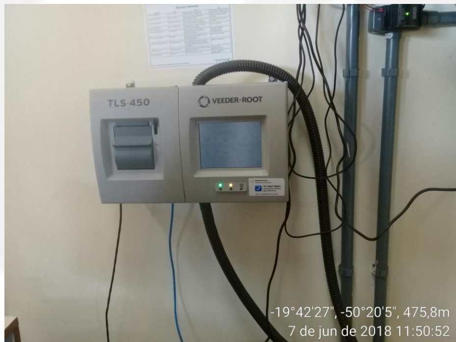
Figura 12- Tela do sistema de monitoramento Intersticial e controle de combustíveis.
