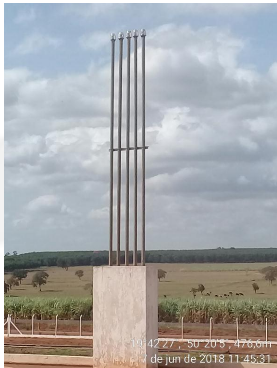
Figura 3- Respiros dos tanques
