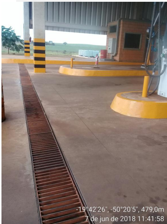
Figura 4- Canaletas de drenagem oleosa
