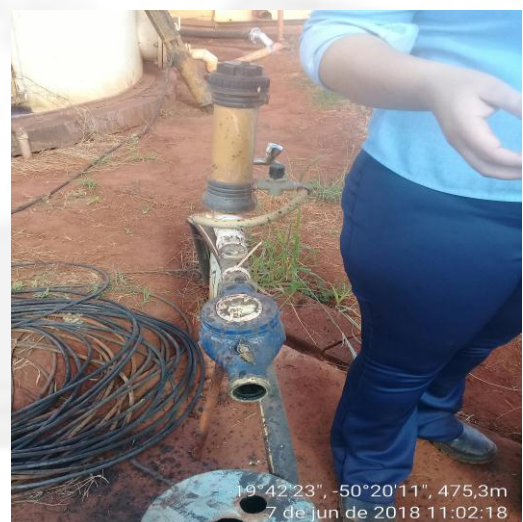
Figura 11- Hidrômetro e demais estruturas do poço.
