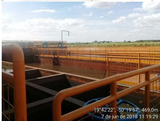
Figura 6- Tratamento dos efluentes líquidos oleosos.
