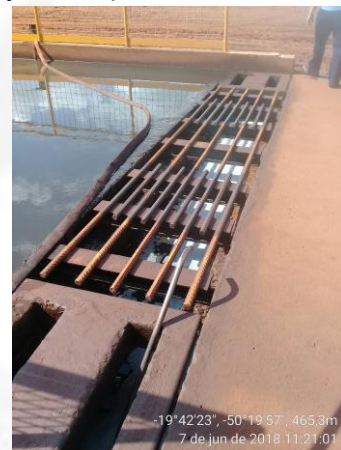
Figura 7- Tratamento dos efluentes líquidos oleosos.
