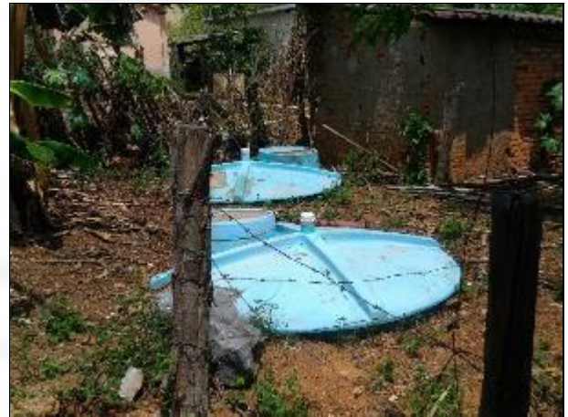
FOTO 10 – Sistema fossa, filtro e sumidouro.
