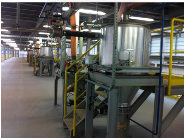
Imagem 03: Silo de dosagem de matéria-prima e insumos.
