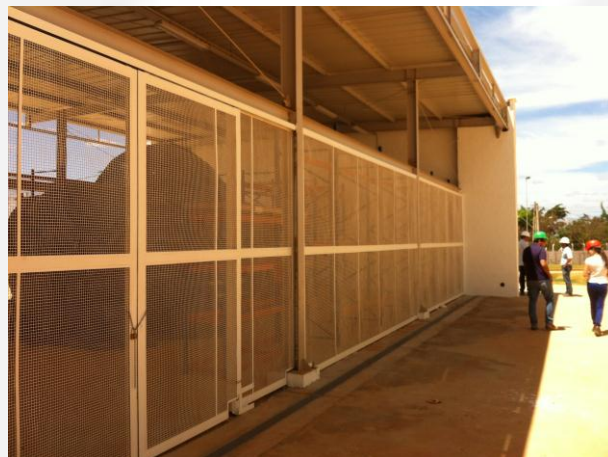
Imagem 18: Central de armazenamento de insumos.
