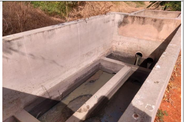
d) Entrada de dejetos no biodigestor.
