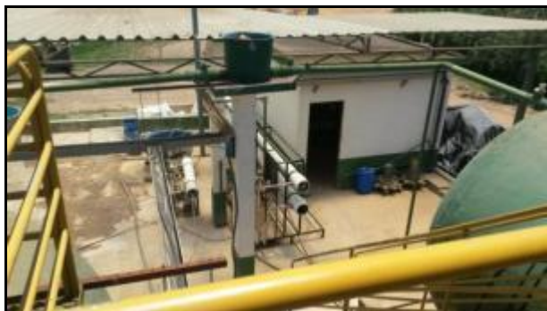
Equipamento de Osmose reversa
