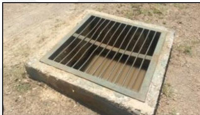
Água separada na caixa SAO
