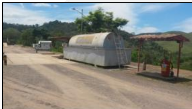
Tanque aéreo, 15m³, diesel, instalado sobre bacia de contenção de vazamentos, interligada à caixa SAO.
