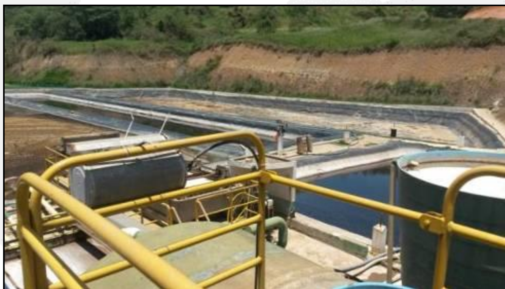
Vista parcial das lagoas de tratamento
