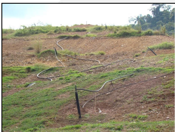
Sistema de drenagem de gases – Fase 1
