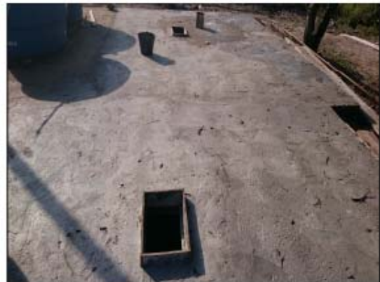
Tanque de armazenamento efluente tratado
