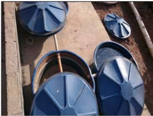
Caixas de filtragem, brita, areia e carvão ativado
