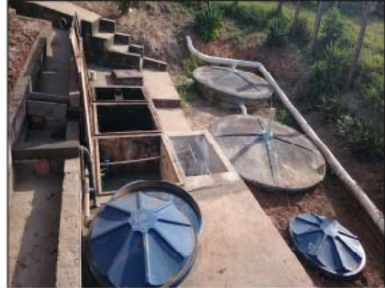
Sistema de tratamento de efluentes Industriais a esquerda e efluentes sanitários a direita
