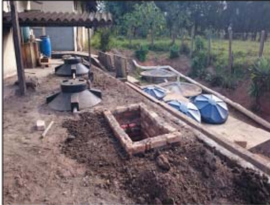
Sistema de tratamento de efluentes Industriais
